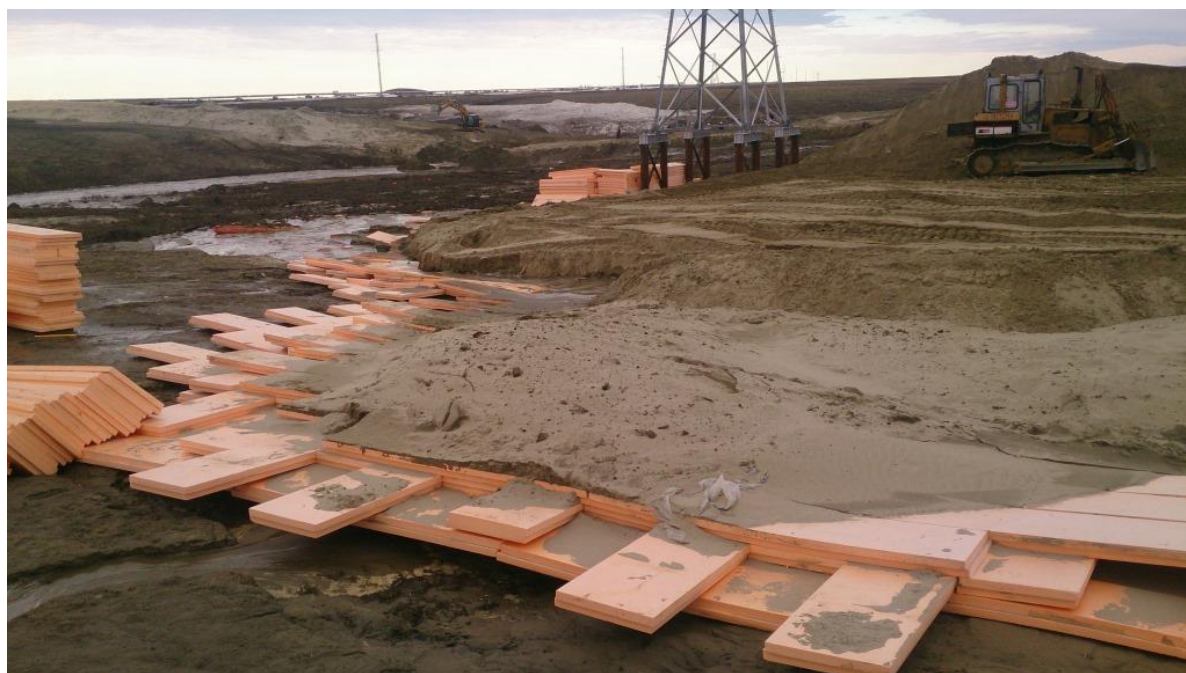
Рисунок 1 – Пример размыва конструкции насыпи с использованием теплоизоляционного материала при несоблюдении требований строительства на ММГ
