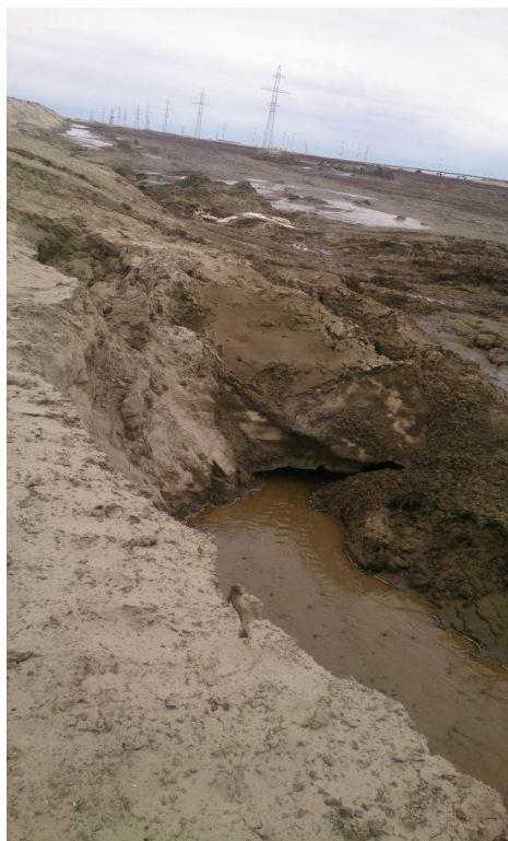
Рисунок 2 – Пример размыва конструкции насыпи при несоблюдении требований проектной документации
